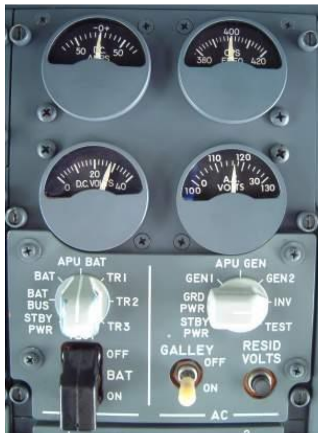
Рис. 4.36. Пульт измерений в сетях переменного и постоянного тока
